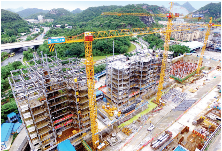
2018 年 8 月,柳州市莲花城保障性住房工程进入紧张施工 (市住建委提供)
